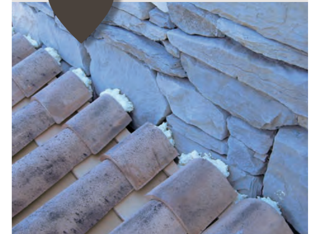
Im Bild ein Beispiel für falsche Installation.
