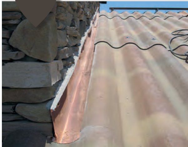
Im Bild ein Beispiel für falsche Installation.
